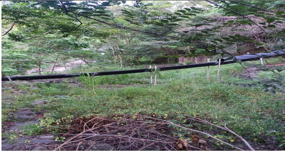
萬山里一號住宅後方懸吊懸空無蓋板排水系統
