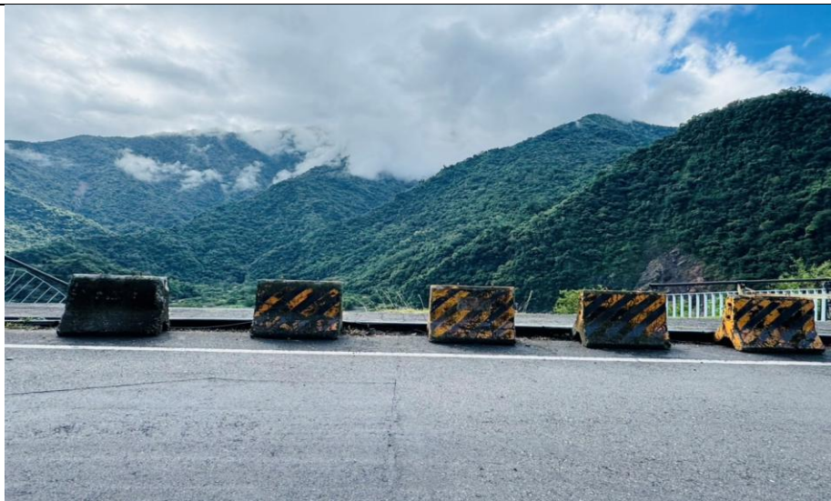
改善高 132 線道路得樂日嘎橋沿路上方護欄 損壞
