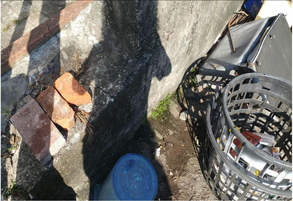
茂林里第四鄰請設置污水處理
