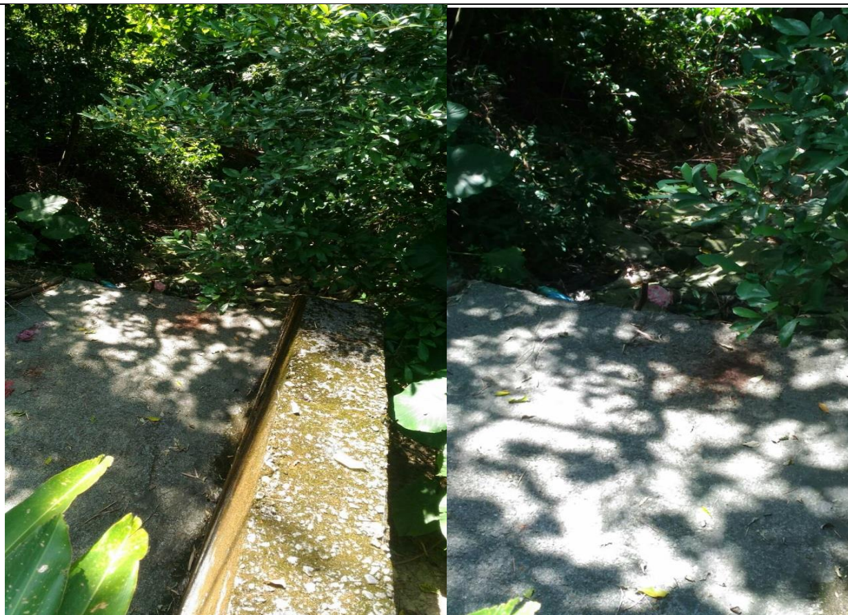
茂林安親班下方排水溝出水口阻塞及排水溝淘空
